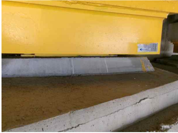
A1-Sh5 받침몰탈 균열(Cw=0.3mm미만)
