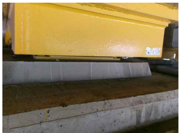
P4-Sh11 받침몰탈 균열(Cw=0.3mm미만)
