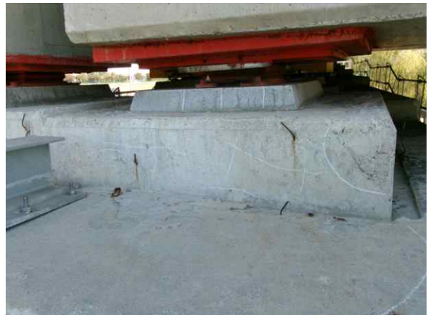
P4-Sh1 받침콘크리트 망상균열(1.5×0.3)
