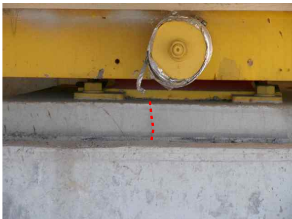
P8-Sh12 받침물탈 균열( Cw=0.3\text{mm} 미만)
