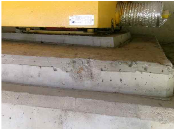
A2-Sh6 받침콘크리트 파손(0.2×0.2)
