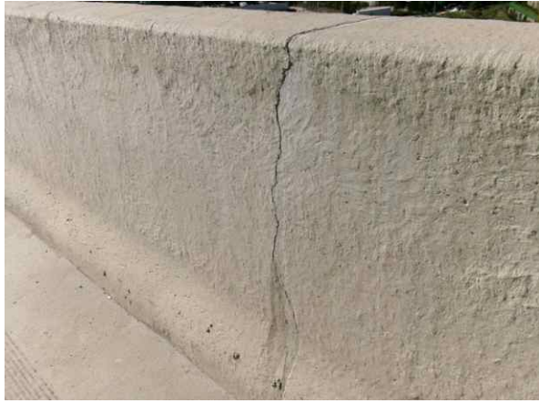
S15 방호벽 균열(Cw=0.3mm이상)
