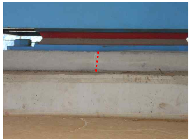
P9-Sh2 받침물탈 균열( Cw=0.3\text{mm} 미만)
