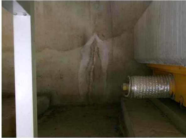
교대 A2 홍벽 균열부백태(0.2×0.5)
