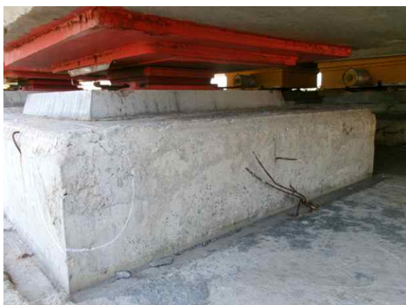
P4-Sh3 받침콘크리트 재료분리(1.0×0.2)
