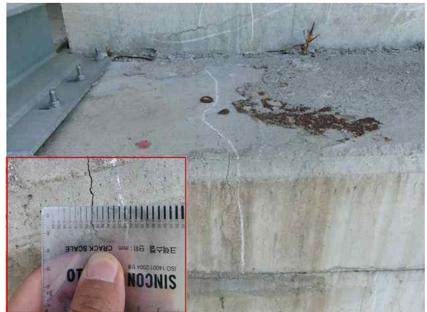
P4 코평부 균열(Cw=0.3mm이상)
